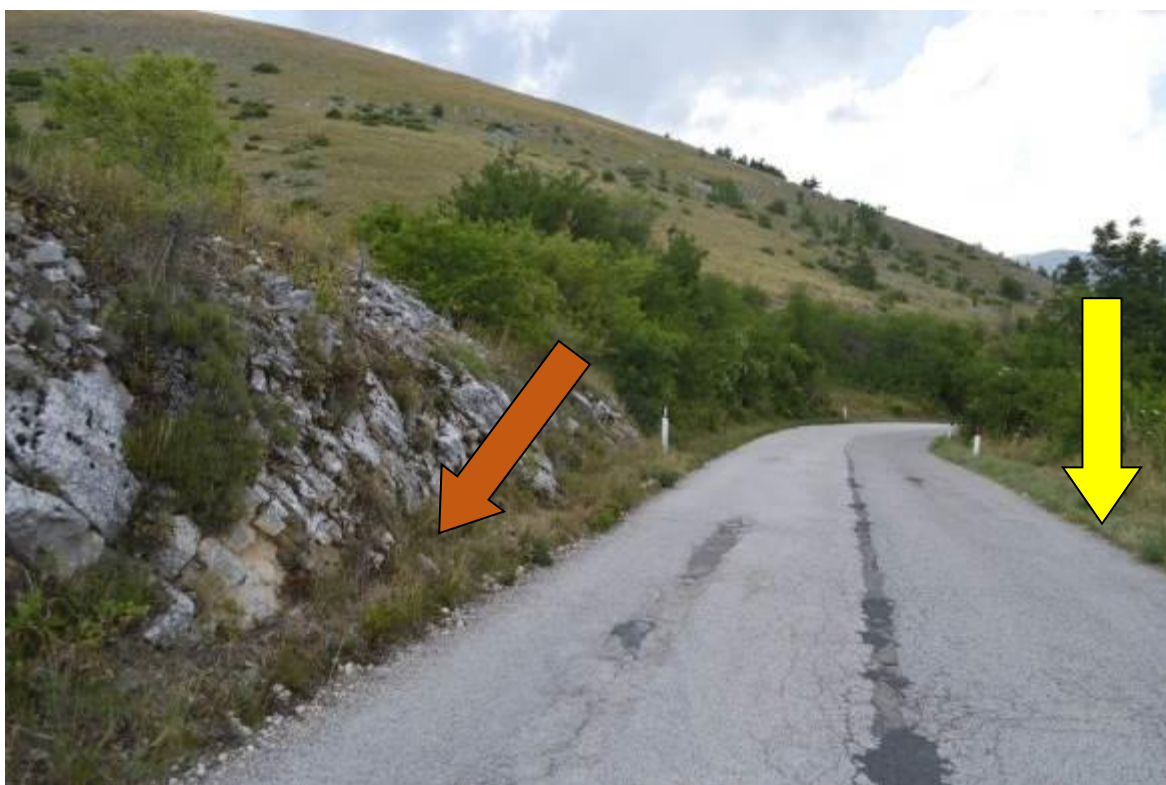
Figura 28 – Altro esempio di tratto stradale sottoposto a sfalciamento irregolare della vegetazione di bordo da parte della Provincia dell'Aquila.
