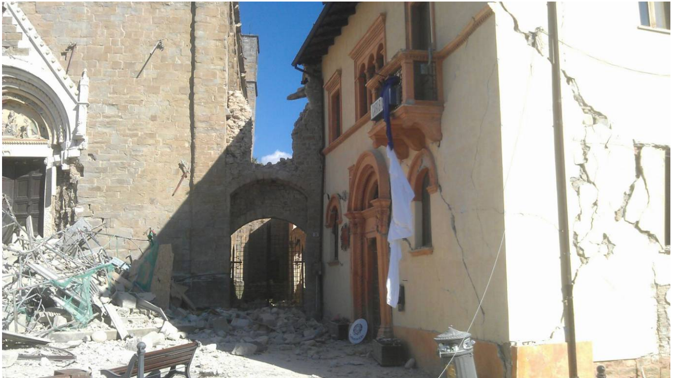
Vista del fronte della sede di Amatrice: evidenti le estese lesioni da schiacciamento per compressione della muratura con deformazione dei pannelli murari ed espulsione di porzioni di muratura come i cunei in corrispondenza degli angoli dell'edificio e degli stipiti delle aperture.
