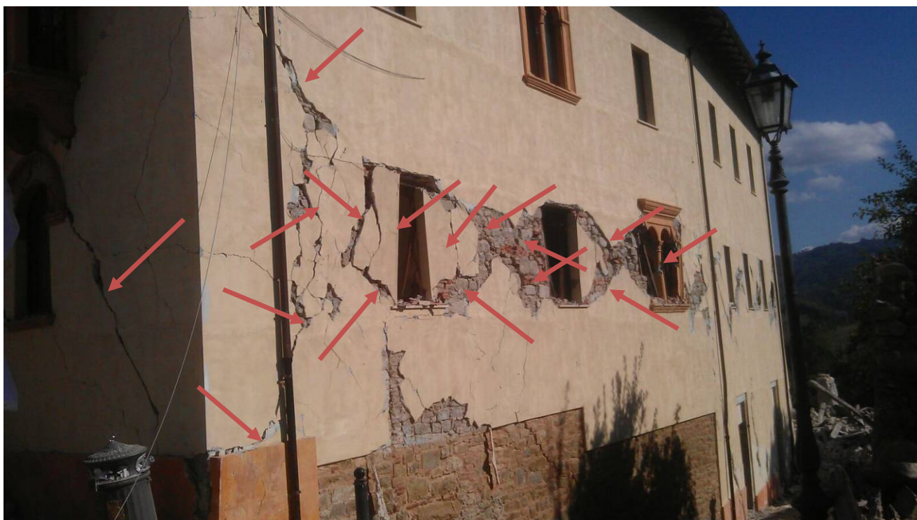
Vista laterale dell'edificio: evidenti le profonde lesioni ad "X" da schiacciamento per compressione dei pannelli murari tra le aperture con espulsione di elementi delle murature e incipiente distacco dello spigolo N-O, con drastico decadimento delle capacità di resistenza della struttura, prossima al collasso.
